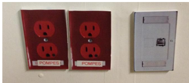
Figure 11 : Fausse prises électriques avec identification de son usage
