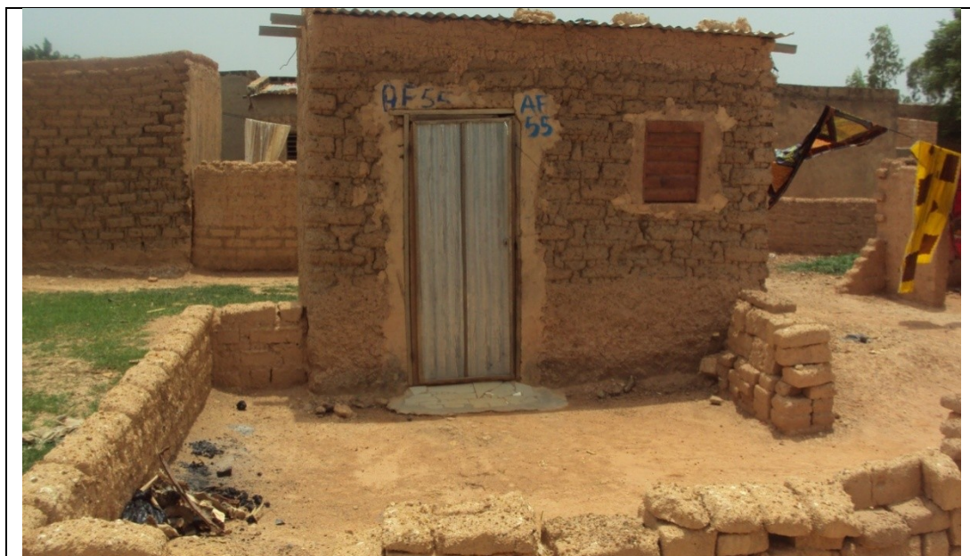
Photo 6 : Ménage 21B002AF0055H001 déclaré comme étant équipé de toilette à chasse, mais qui dans la réalité ne dispose d'aucun type de toilette
