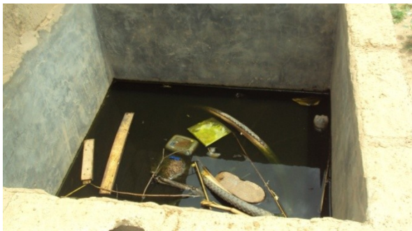
Photo 2 : Puisard contenant les eaux usées et des déchets solides dans la cour d'une maison d'habitation au quartier loti de Tanghin
