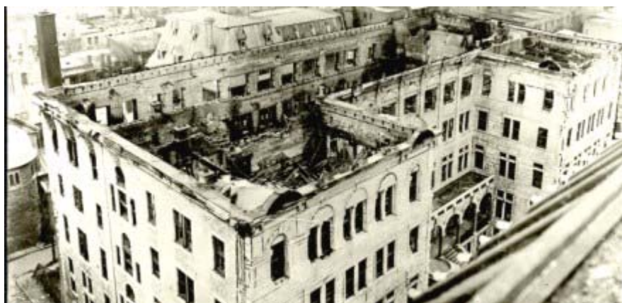
L'immeuble principal de l'Université de Montréal, rue St-Denis, à la suite de l'incendie de 1922 (Service des archives et de la gestion des documents, fond 1FP, 5004).
