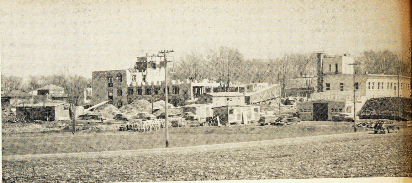
Les nouveaux laboratoires de l'Institut de Microbiologie en construction à l'Annexe de l'Institut, à Laval-des-Rapides.
