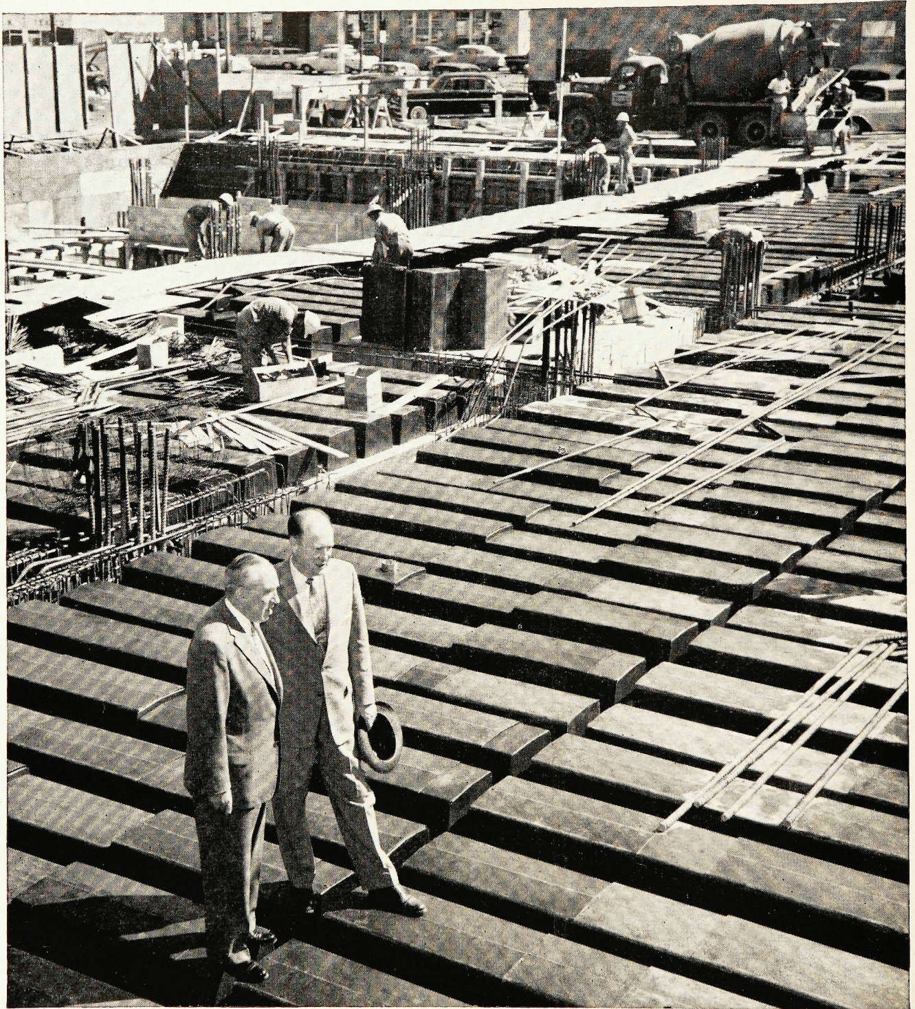
Le gérant de l'une des succursales de la Banque Royale à Calgary (Alberta) suit la construction du nouvel immeuble d'un client.
