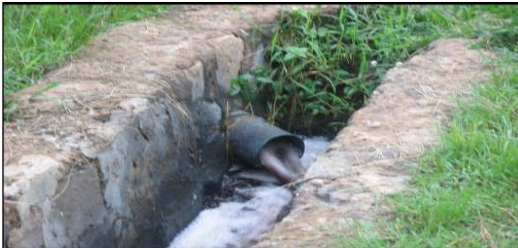
Figure 24. Les canalisations obstruées
