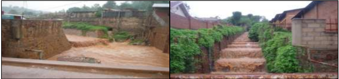
Figure 4. Le ruissellement à Kinamba vers Nyabugogo
