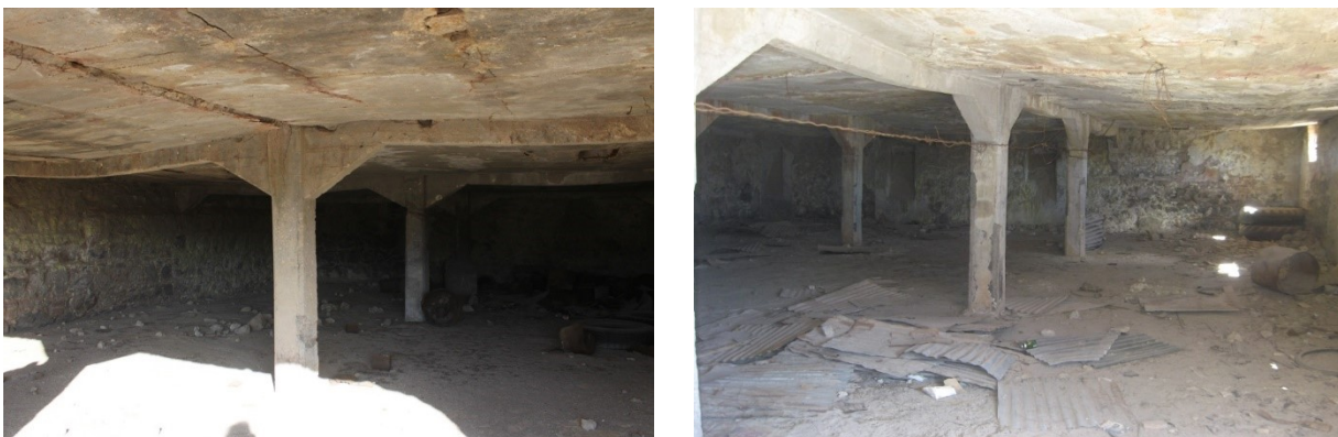
Figure 152. Buenaventura, secteur 2 (intérieur), matériaux en surface
