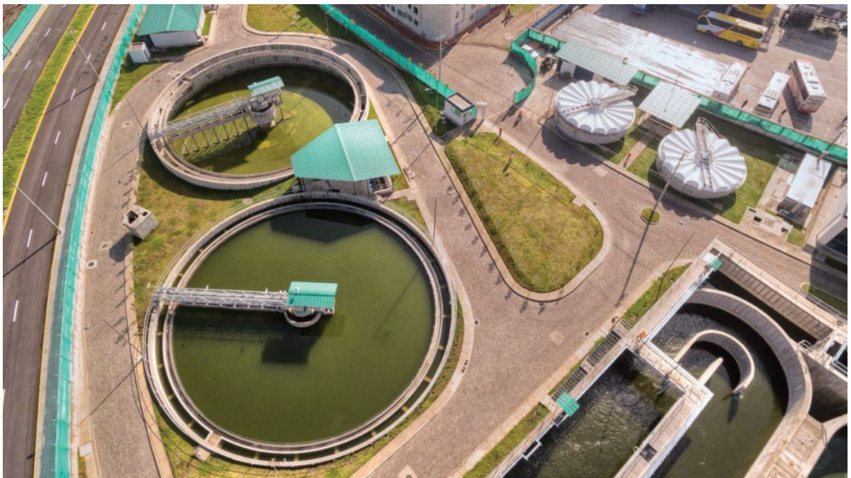
Figure 22. Plante de traitement des eaux usées PTAR-Quitumbe
