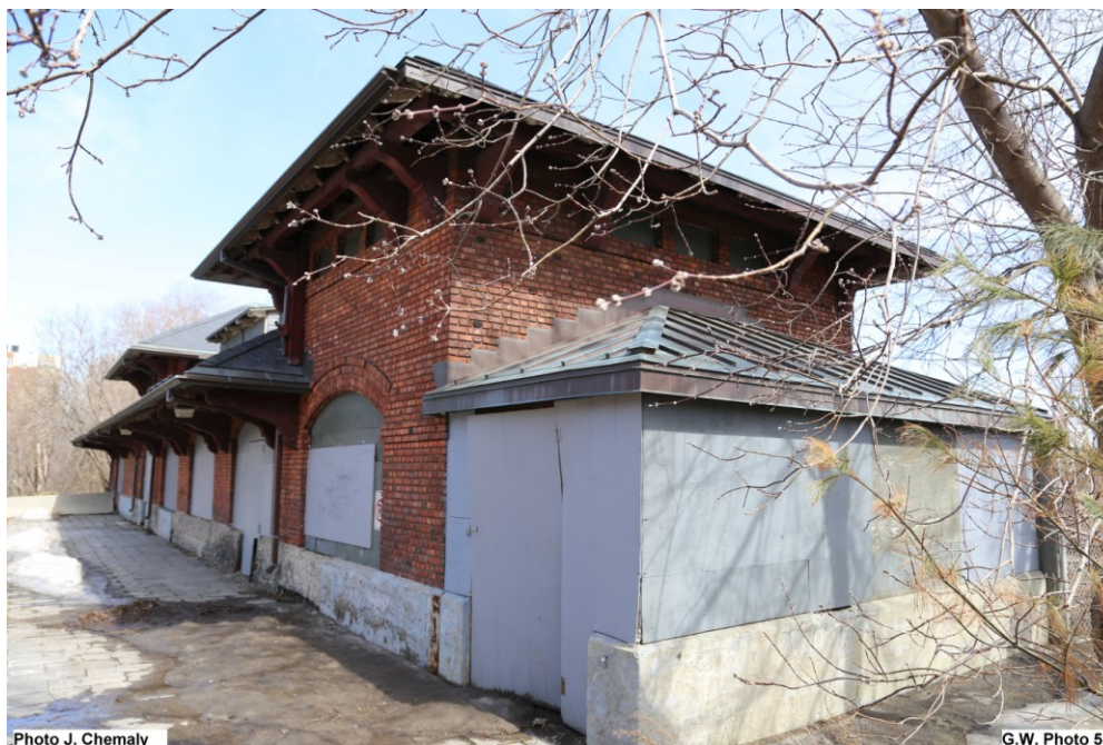
Vue extérieure de biais de la gare de Westmount. Photographie personnelle de Joumana Chemaly. 16 avr. 2015.
