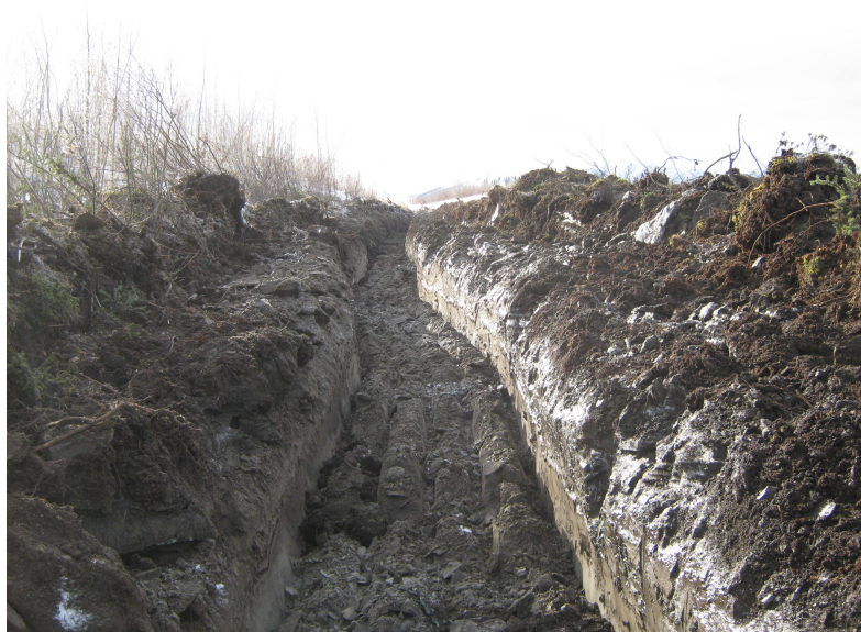
Figure 1.4 – Une tranchée drainante a été excavée en 2010 le long de la Alaska Highway, Beaver Creek, YT (photo prise le 8 Octobre 2010). Crédits : Paul Murchison, Yukon Highways and Public Works
