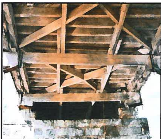
Figure 6. Les plaques métalliques reliant les tiges de chaque côté de la ferme au pont McVetty-McKerry (61-18-08)
