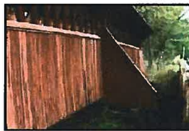
Figure 8. Le contrefort du pont de la Frontière (61-11-03)
