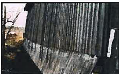
Figure 9. Le pont Drouin (61-18-01) dont les tirants d'acier sont à l'extérieur du lambris à simple jet d'eau
