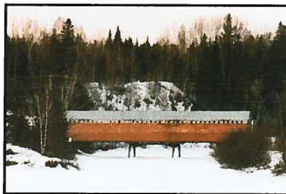
Figure 10. Le pont de Macaza (61-33-10) dont la portée est soutenue par un banc en acier.
