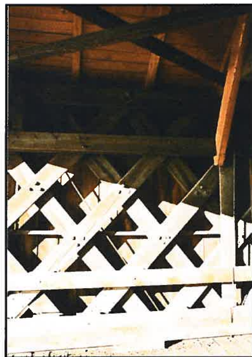
Figure 2. Le pont Freeport (61-45-02), un bel exemple de ferme de type Town simple.
