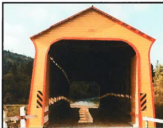
Figure 2. Le pont du Sault (61-39-01) peint avec des restes de peinture à signalisation jaune et orange.
