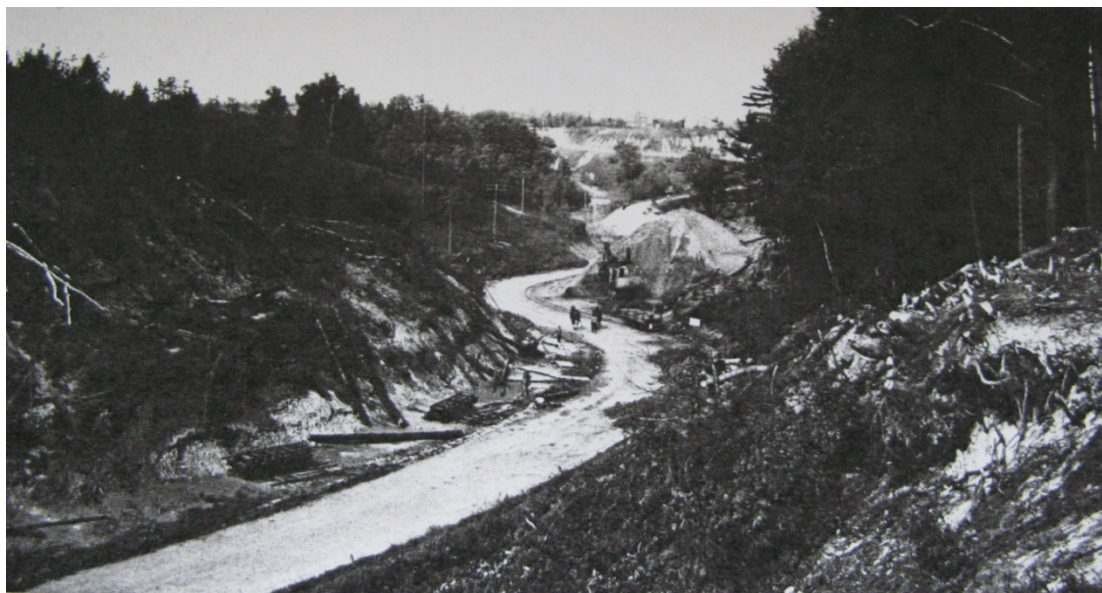
Figure 42 : Travaux sur la route n° 2 à la hauteur de Rouge Hill en Ontario. Sur cette image, il est possible de voir l'important travail d'aménagement réalisé pour la construction d'une route et les traces du passage récent de la machinerie (et des chevaux) : coupe d'arbres, éradication de la végétation, aménagement des pentes, remblayage, etc. Source : N. D. Bennett et A. A. Walters, The Back Fifty , Toronto, Ontario Department of Highways, 1966, p. 7.
