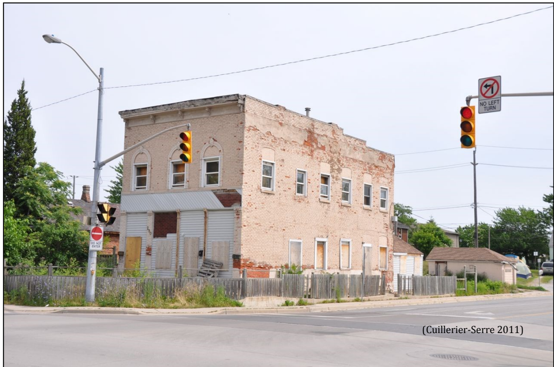
FIGURE 4,15 : IMMEUBLE RÉSIDENTIEL DÉPÉRISSANT FACE AU CÔTÉ EST DU CASINO
