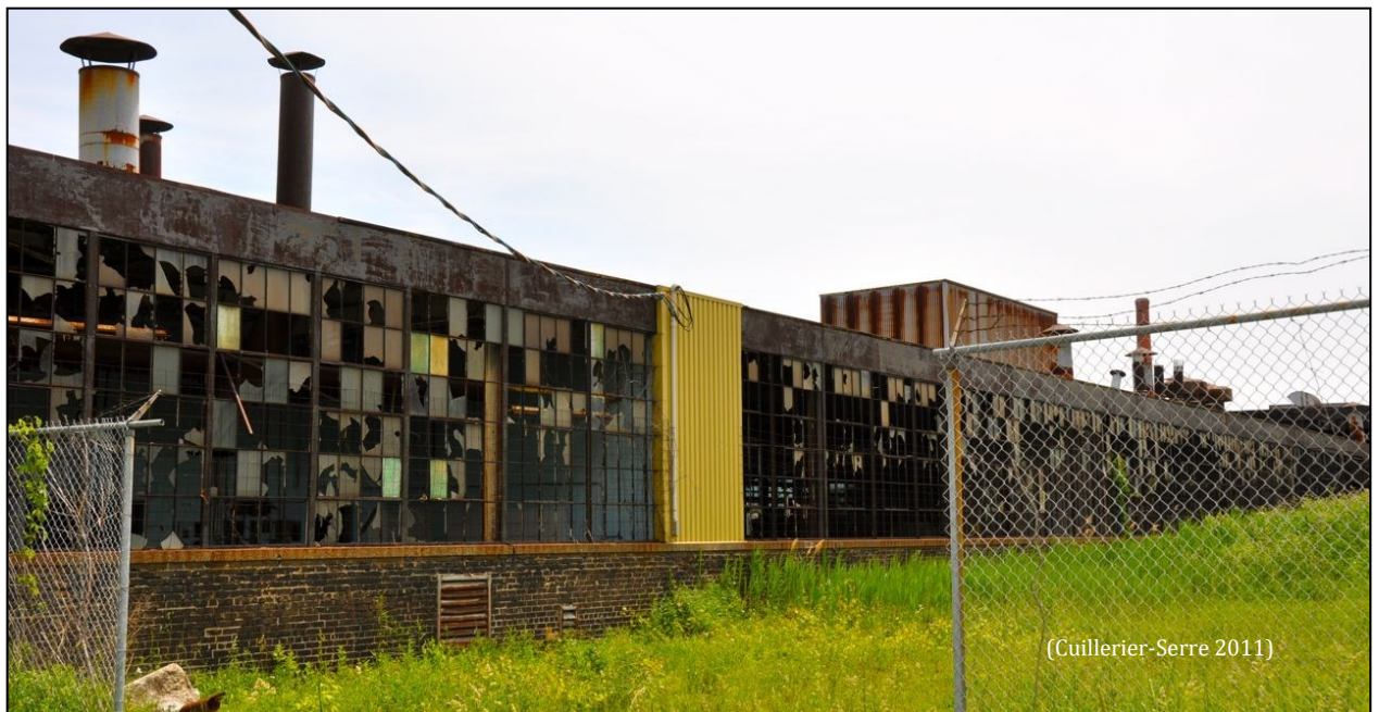
FIGURE 4,12 : BÂTIMENT INDUSTRIEL LAISSÉ À L'ABANDON, FORD CITY
