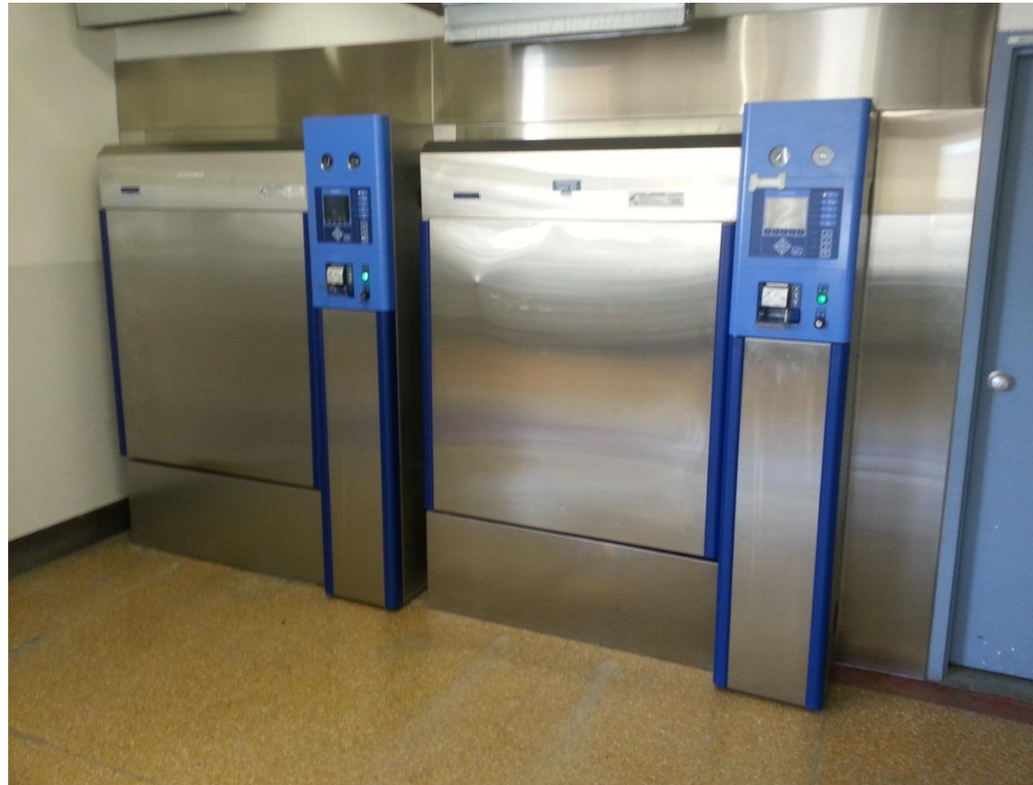
Figure E.3 : Stérilisateurs chaleur de l'URDM
