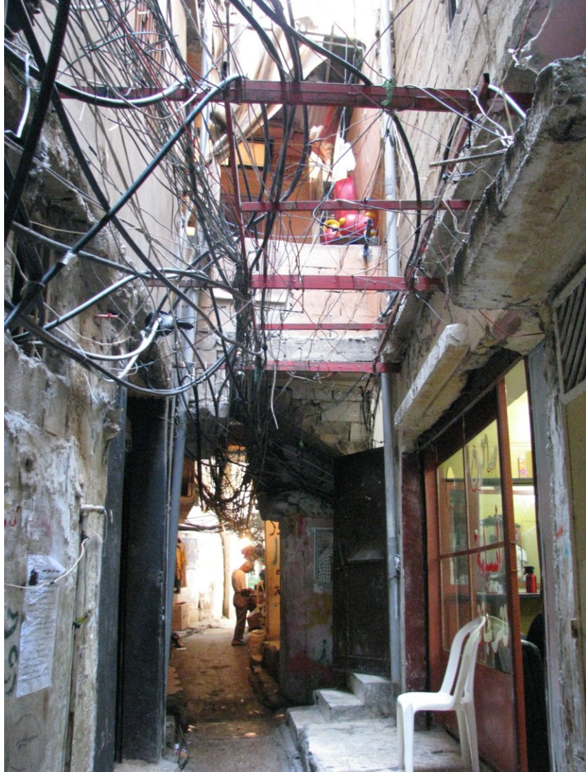
Figure C.4 Ruelle typique du camp de Bourj El Barajneh. On peut y observer les multiples câbles (eau et électricité) entremêlés.
