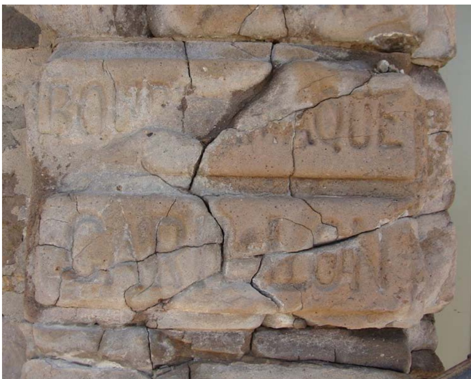
Figure 24: Exemple de conservation préventive sur le portail du Fort Chambly, Chambly, Québec. État d'une pierre fracturée avec ses inscriptions avant consolidation. Photo de l'auteur, 2010.
