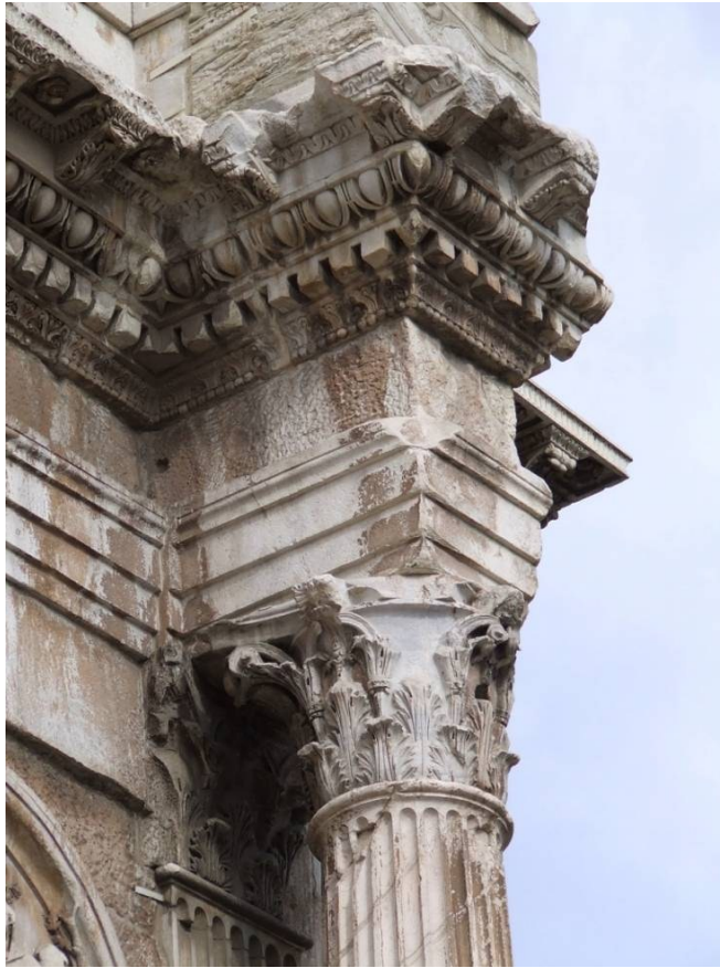
Figure 14: Exemple de lacune maintenue à l'état de lacune sur chapiteau corinthien. Arc de Constantin 315 apr. J.-C., construit en l'honneur de la victoire de Constantin sur Maxence à la bataille du pont Milvius. Photo de l'auteur, 2007.
