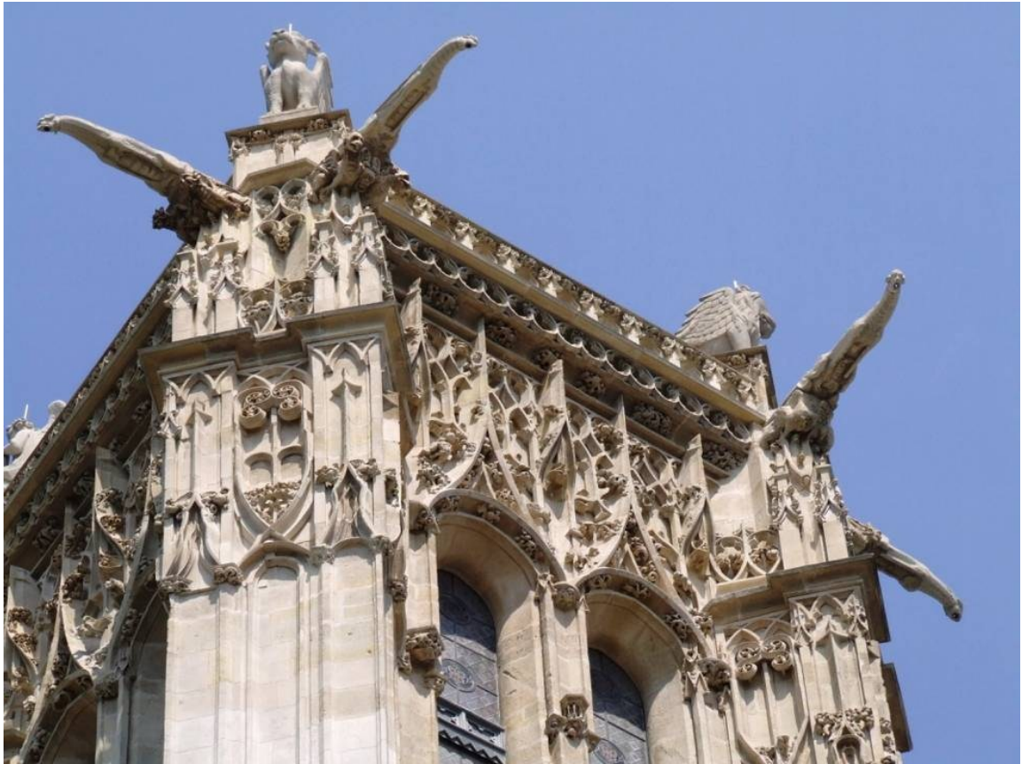
Figure 16: Exemple de ripristino ou reconstruction à l'identique. Tour St-Jacques, Paris, 1509-1523, classée Monument historique en 1862. Cette tour constitue le seul vestige de l'église Saint-Jacques-de-la-Boucherie. Le chantier de restauration entre 2006 et 2009 a eu pour objectif de remplacer les pierres posées au XIXe siècle, de nettoyer les sculptures existantes encore en bon état et de restituer à l'identique les sculptures endommagées ou disparues 341 . Photo de l'auteur, 2010.
