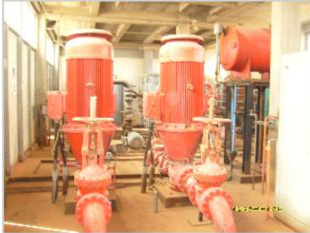
Figure 10 : Deux pompes centrifuges
