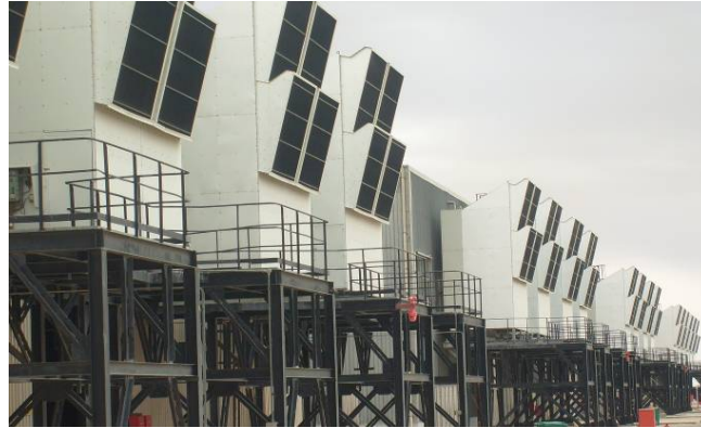
Figure 8 : Vue extérieure des modules contenant les dix-huit turbocompresseurs
