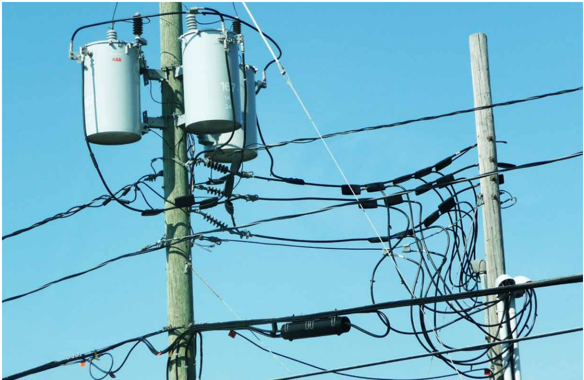
Figure 40 : La gestion des câbles.
