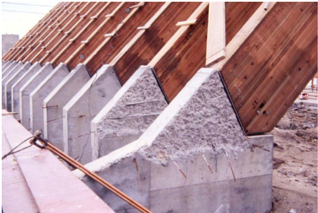
Figure 145 : Pavillon du Canada à l'Expo Osaka 1970, projet d'Arthur Erickson et Geoffrey Massey (1967). Photo du chantier le 16 décembre 1968, éléments préfabriqués de béton dans lesquels viennent s'encaster les portiques de bois au moyen d'un joint métallique. Source : Fonds d'Archives Erickson, CCA
