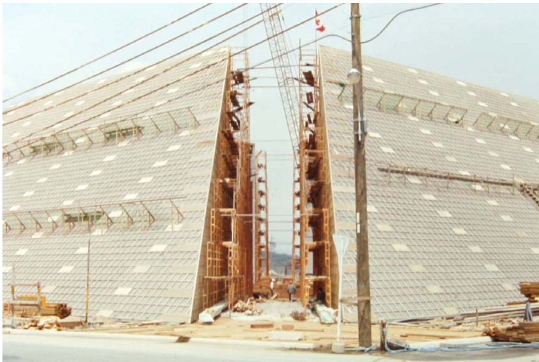
Figure 147 : Pavillon du Canada à l'Expo Osaka 1970, projet d'Arthur Erickson et Geoffrey Massey (1967). Photo du chantier au début de l'installation du revêtement miroité, mai(?) 1969. Source : Fonds d'Archives Erickson, CCA
