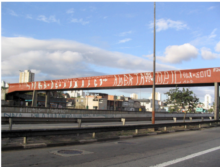
Figure 93 : Pichações sur passage à niveau
