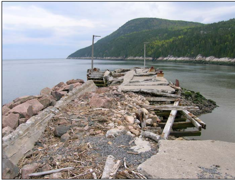
Figure 64. Tablier du quai de Port-au-Persil. L'ancien revêtement de béton armé subsiste toujours sur le quai. Photo: Frédéric Simard
