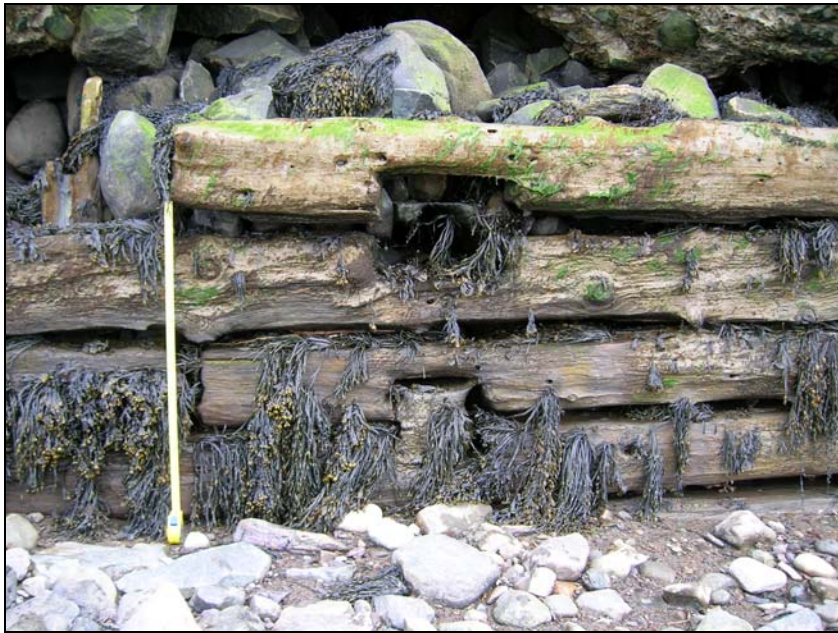
Figure 7. Parement de longrines du quai Tâché
