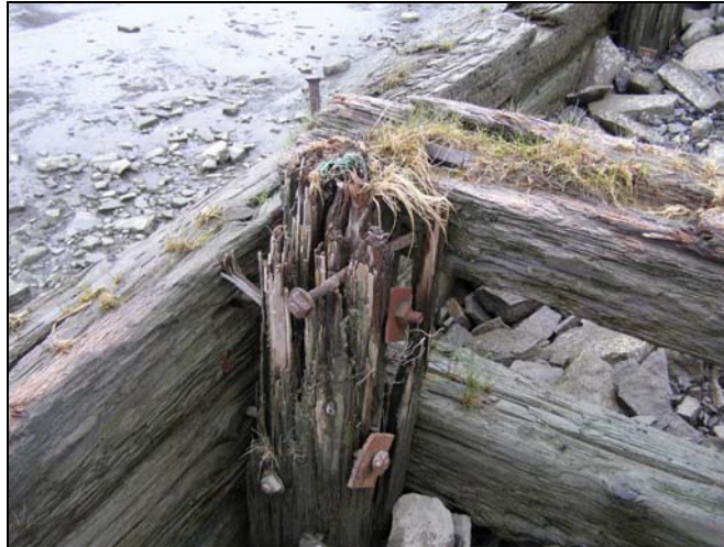
Figure 67. Boulons écroués en partie médiane des vestiges du quai de Sainte-Famille
