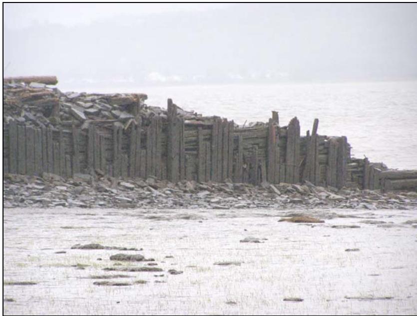
Figure 44. Partie distale du quai de Sainte-Famille. Parement de palplanches disposé sur le flanc est des vestiges Photo: Frédéric Simard
