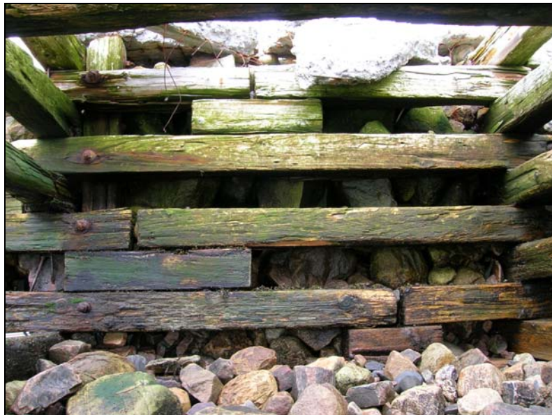
Figure 63. Structure interne des coffrages à Port-au-Persil. Des cales de soutien apparaissent aux aboutements des pièces de charpente. Photo: Frédéric Simard
