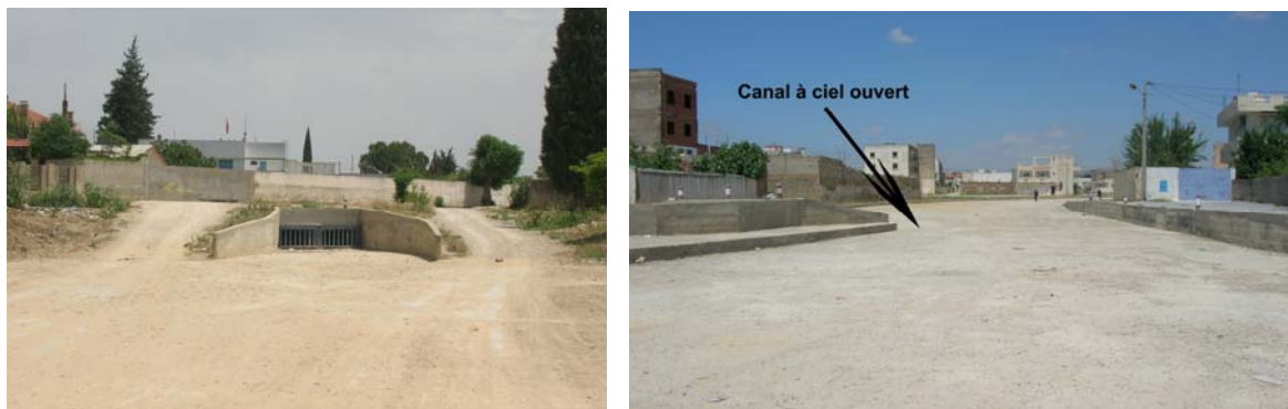
Canal à ciel ouvert servant à une protection rapprochée réalisé par le Ministère de l'équipement et de l'habitat (achevé à 80%). (Photo : Bouraoui, 2009-05-28)
