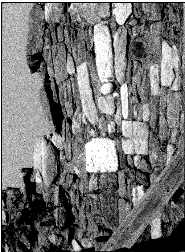
2. Mur C, partie nord, dans la pièce 3, possibilité d'une ouverture murée
