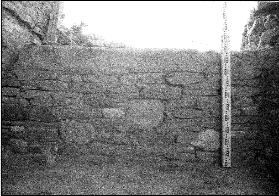
1. Mur F, partie antérieure en pierre, partie supérieure en pisé, vue de l'ouest
