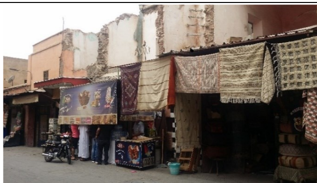
Figure 75: Maison en ruine au-dessus des boutiques dans une ruelle commerçante
