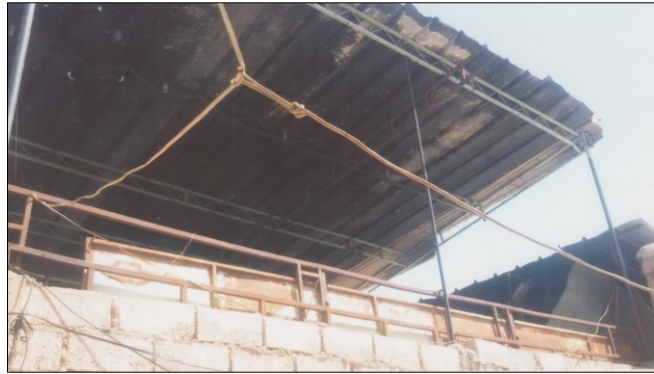
Figure 60: Couverture en zinc d'une terrasse exposée aux regards des voisins. (Photo d'archive du service de l'urbanisme).
