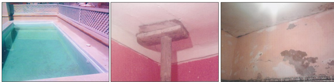
Figure 68: dégâts d'eau sur le plafond et les murs d'une maison emboîtée dans une maison d'hôte équipée d'une piscine en terrasse. (Source : archive des plaintes, service de l'urbanisme)
