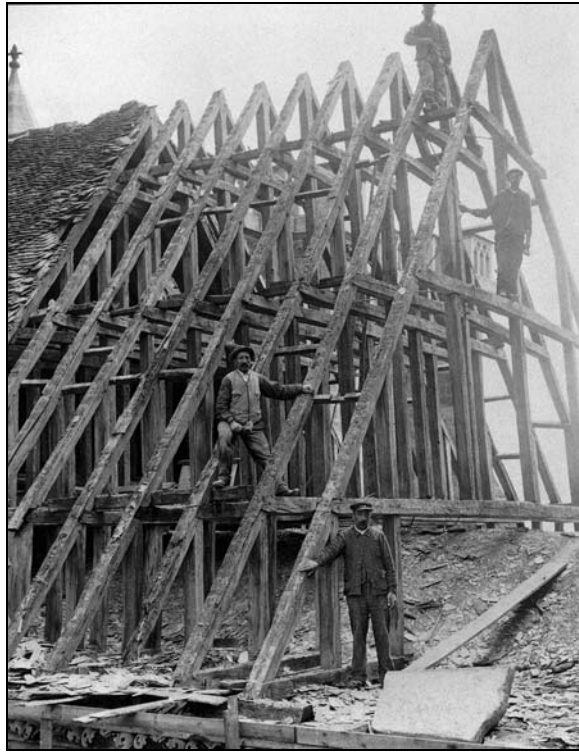
Figure 6. Exemple de charpente de toiture appartenant au corpus sur lequel a travaillé Hoffsummer. Bras nord du transept, Cathédrale Notre-Dame, Laon (Aisne). (Source : Corvol, Hoffsummer et Mayer, 2002, p.10).
