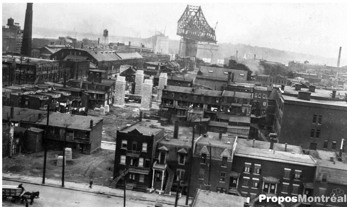
Figure 2 : Mise en chantier du pont du Havre (~ 1926, aujourd'hui nommé Jacques-Cartier). Construction de piliers dans la cours des maisons non démolies, mais tout de même expropriées (boulevard Maisonneuve Est ?).
