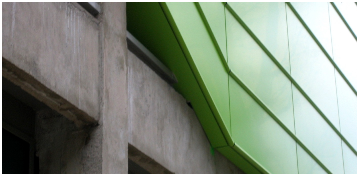
Figure 36: Jakob+MacFarlane, Docks en Seine, Cité de la mode et du design, Paris, 2004-2008. Détail de la jonction entre le bandeau de la façade côté quai et l'ossature de béton armé. Photographie de l'auteur.
