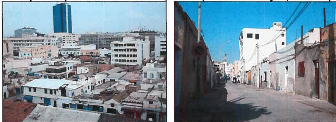
FIGURE 50 et FIGURE 51 : Vues montrant l'état de dégradation des ateliers et des entrepôts du quartier de la Petite Sicile (Source : photos Sofïène Ayadi, avril 2007)
