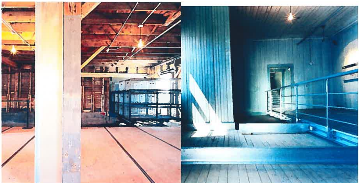
Figure 24 (À gauche) Vue de la structure nouvelle qui double la structure originale de bois.
