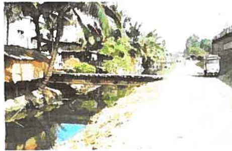
Un des ponts qui a besoin d'être reconstruit
