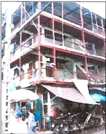
Le bloc S de l'immeuble collectif Nguyễn Kim (district 10, Ho Chi Minh Ville) en état de détérioration avancé
