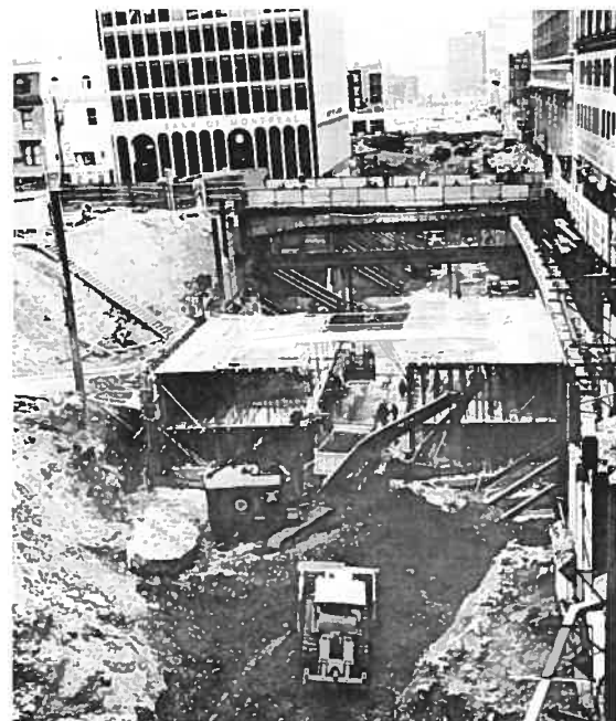
Figure 7 Construction de la station de métro Peel sous le boulevard de Maisonneuve, 1962. Ville de Montréal
