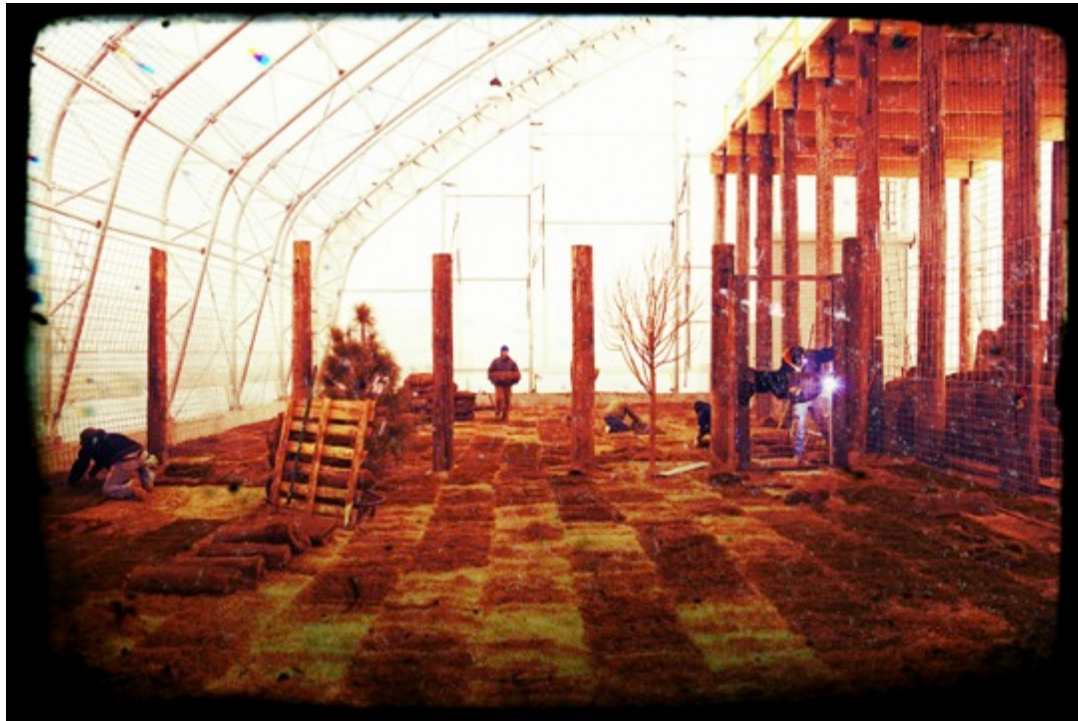
Figure 6 : Construction, au WAS, d'un nouvel espace pour accueillir les tigres récemment acquis par le sanctuaire suite à la décision du Président bolivien de bannir l'emploi des tigres dans les cirques du pays. Photo originale de Otto Schulze pour le Wall Street Journal 73
